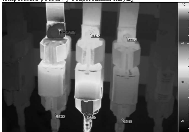
Rys. 3. Termogram pole nr 2 rozdzielni niskiego napięcia
